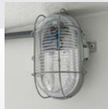
Abschließbarer Abstellraum mit LED-Beleuchtung und Steckdose
